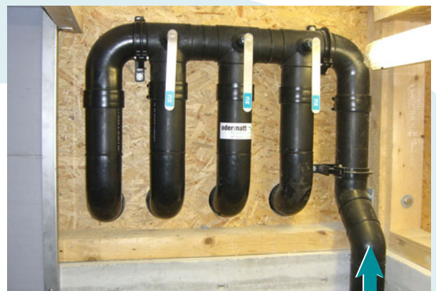
Fördern zur Umspülung
