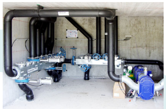
Pumpenhaus mit Pumpe, Saug- und Druckstation. Schieber pneumatisch und funkgesteuert.
